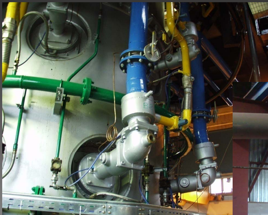
Горелки серии Thermal установленные на шахтной печи
